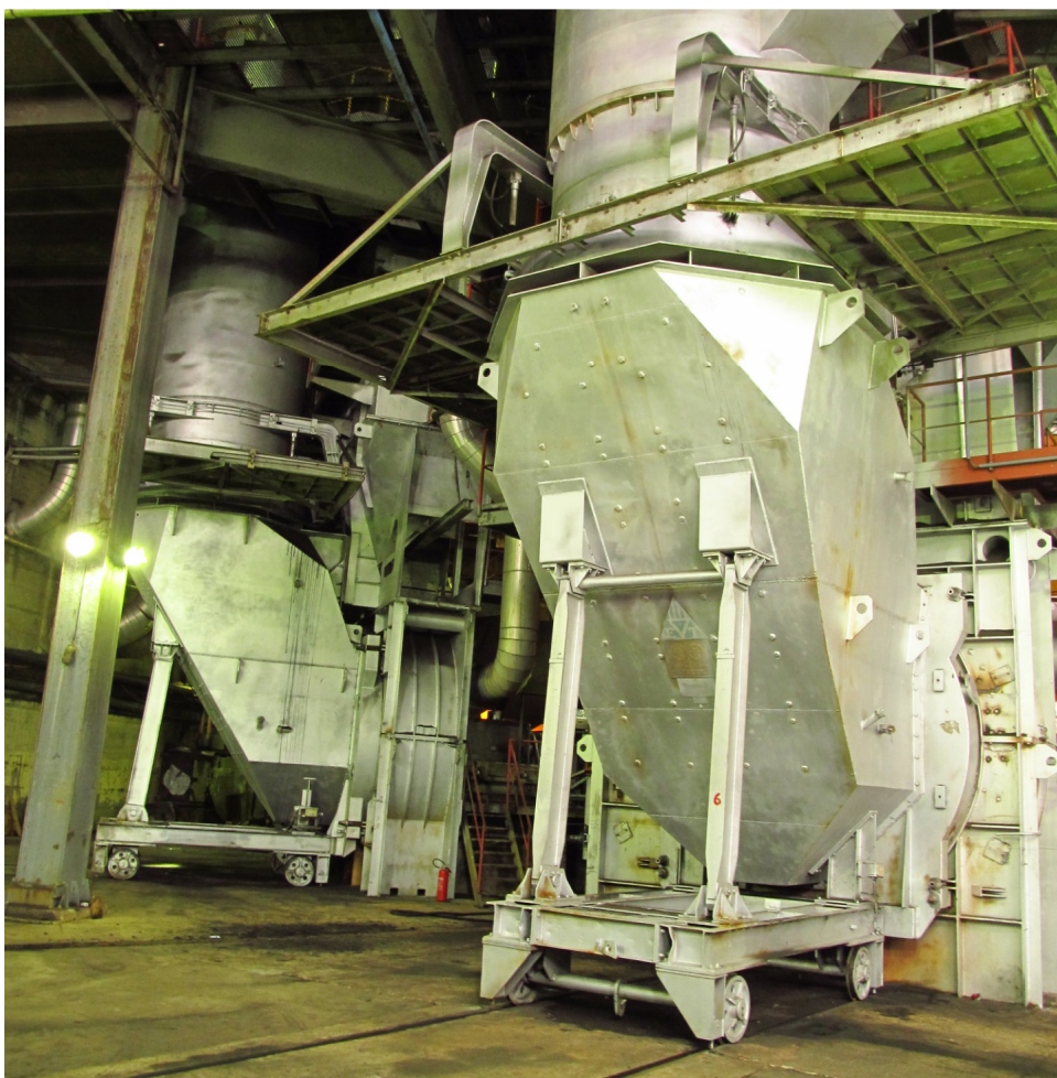
Rys. 9.1 Wentylatorowe młyny węglowe N 270.45 pracujące na węgiel brunatny
