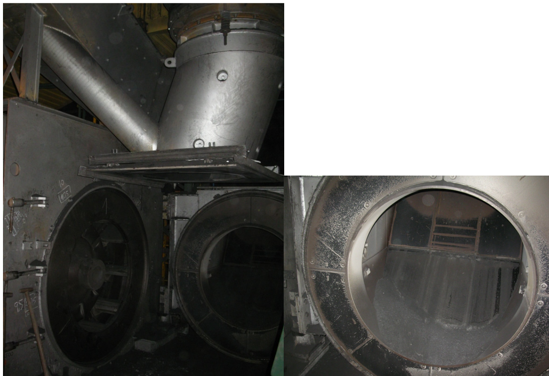
Rys. 8.4 Młyn z otwartymi drzwiami, fragment rurosuszarki i kanału nawrotu pyłu z odsiewacza do młyna, widoczne pozostałości żaluzji w drzwiach
